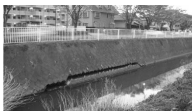
河川護岸の崩壊
