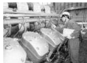
自家発電設備の維持管理
