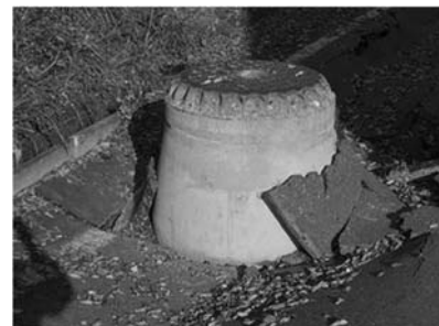
地盤の液状化によるマンホール浮上 （中越地震 新潟県川口町）
