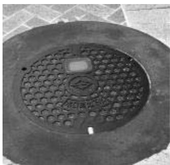
水位周知下水道マンホール蓋
