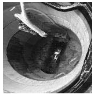
水位周知下水道マンホール内部
