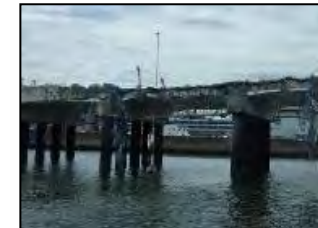
南本牧はま道路の損傷(中区)
