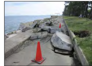
護岸損壊(金沢区)
