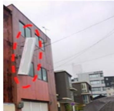
【看板の取付部が経年劣化し、強風により取付部が外れて傾いている状況】
