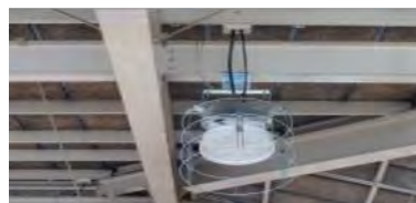
体育館照明 整備例
