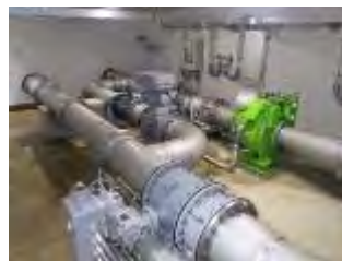
恩田配水池 小水力発電設備
