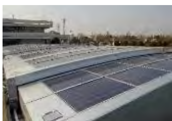
小雀浄水場ろ過池 太陽光発電設備
