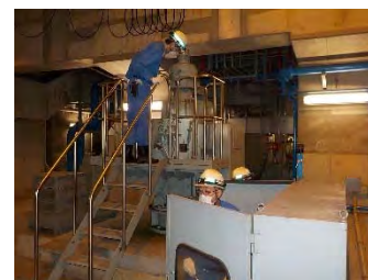
主ポンプ設備の維持管理
