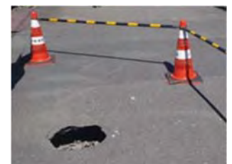
取付管破損による道路陥没
