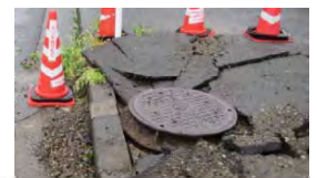
マンホール浮上被害状況
