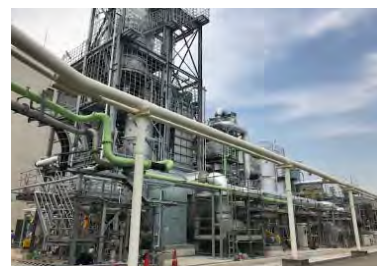
下水汚泥燃料化設備
