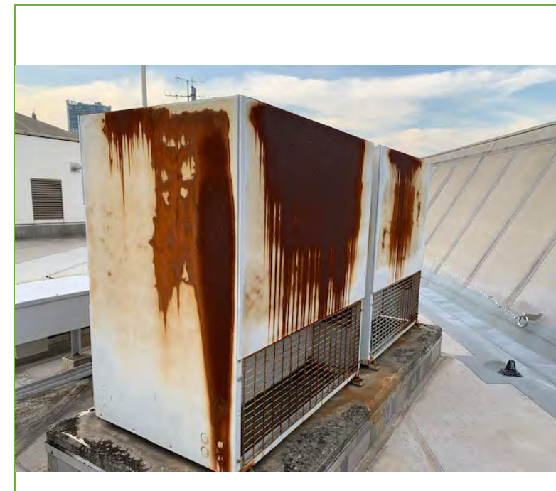
現況写真②（空調設備）
