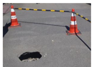
取付管破損による道路陥没
