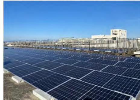
PPAを活用した学校への太陽光発電設備の設置
