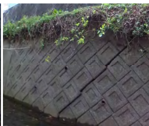
護岸ひび割れ・はらみだし
