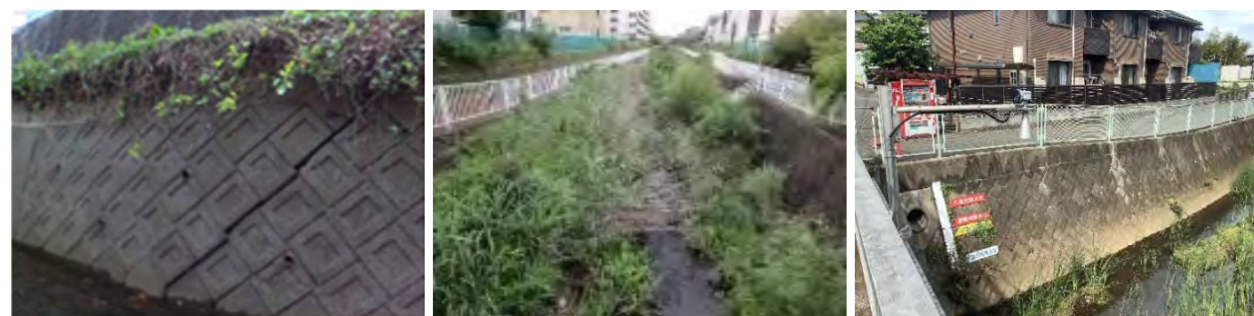
河川施設の変状（ひび割れ）
