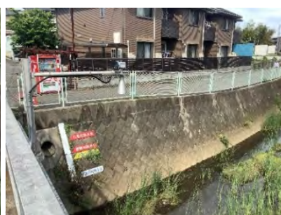
水防機器の管理
