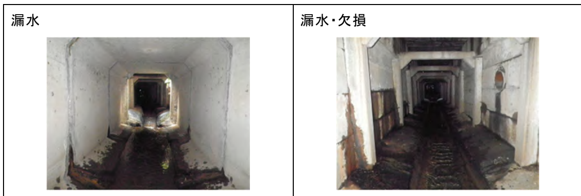
図 2-4 暗きよの変状例
