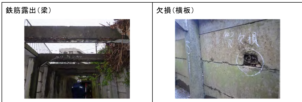
図 2-3 柵きよの変状例
