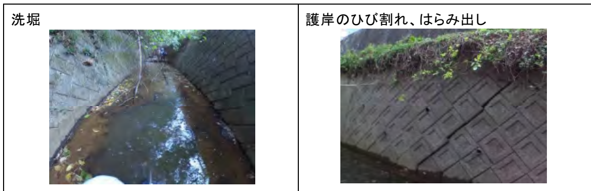
図 2-2 護岸の変状例
