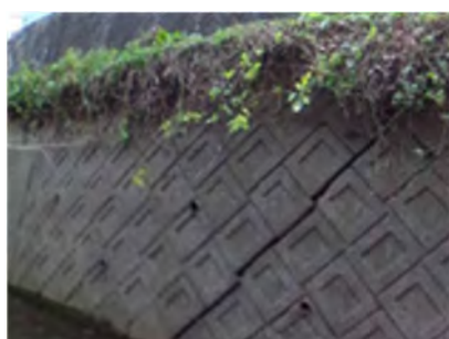
施設の変状(ひび割れ)
