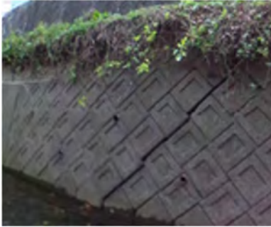
河川施設の変状 (ひび割れ)
