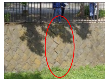
護岸のひび割れ
