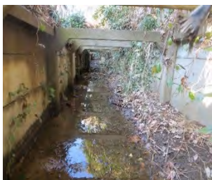
土砂堆積・植生繁茂
